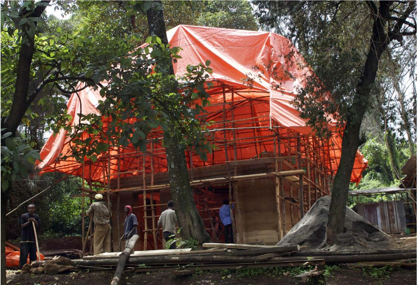
Im Bau: SUDU, der Forschungsprototyp eines preiswerten mehrstöckigen Wohnhauses aus lokalen Baumaterialien.
